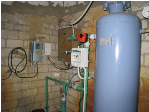
Sūkņu mājā uzstādītā atdzelžošanas iekārta
