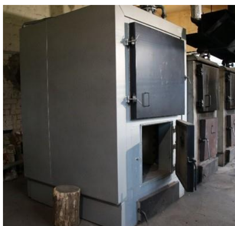
5. att. 2020. gadā katlu mājā tika uzstādīts papildus apkures katls
